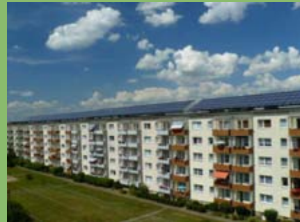
Größte auf dem Dach montierte Photovoltaik-Anlage der neuwo
