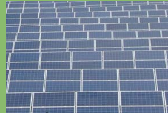
Ein Meer aus photovolt. Zellen IBC Solar
